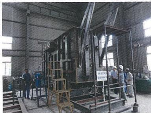
トランス(変圧機)
